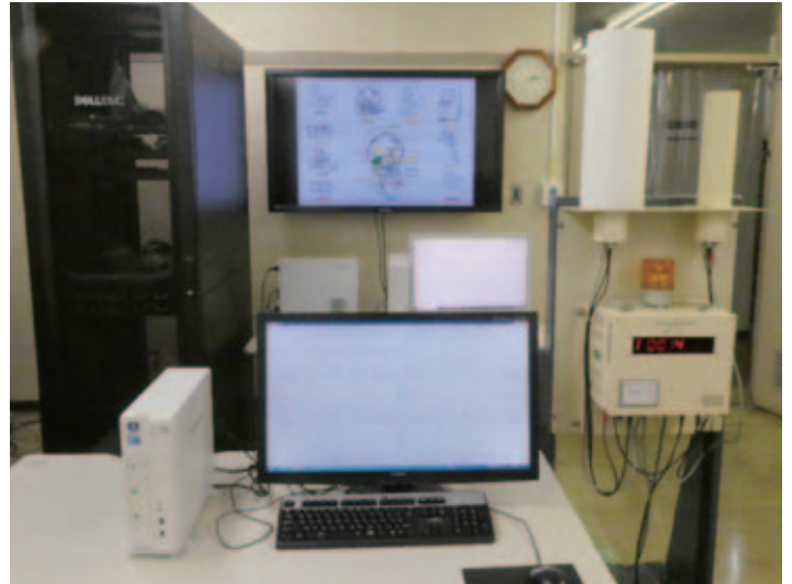
放射線集中監視システム
